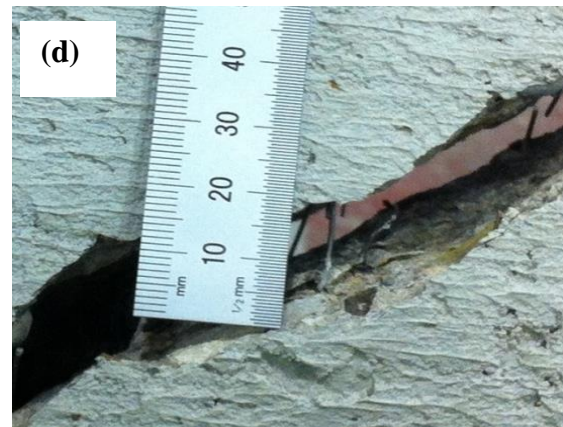
(d) Excessive crack opening
